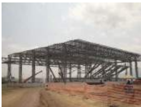
Figura 5: Arena de Handebol estruturada em aço (Parque Olímpico – Rio de Janeiro, Olimpíadas 2016). Foto: Silvia Scalzo.
