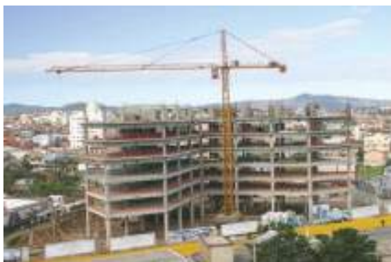
Figura 71: Obra do Edifício Comercial Terra Firme em São José (SC), com 14 pavimentos em sistema híbrido
