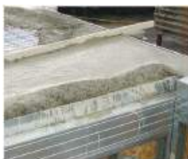
Figura 52: Laje Úmida (Fonte: CBCA)
