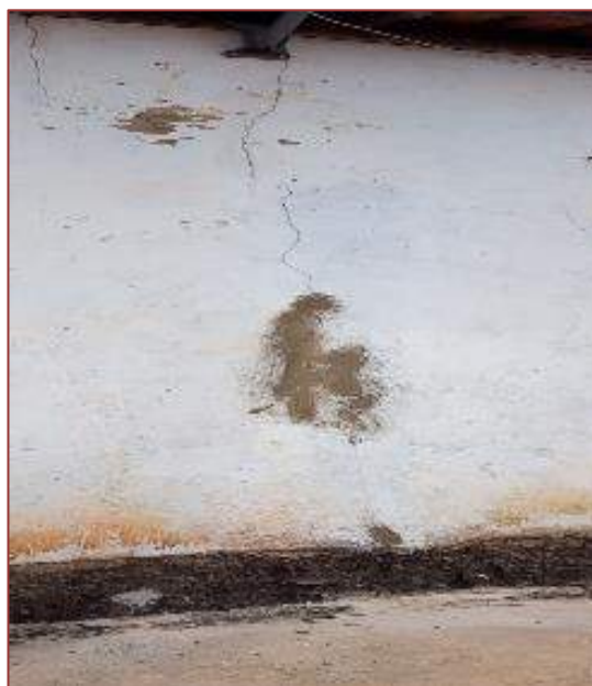
Figura 3- Trinca do ponto “A”
