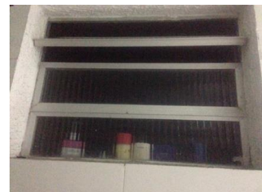
Figura 37- Basculante em banheiro
