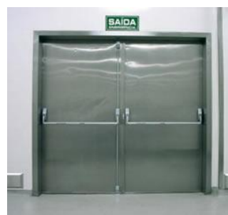
Figura 176 - Porta corta fogo
