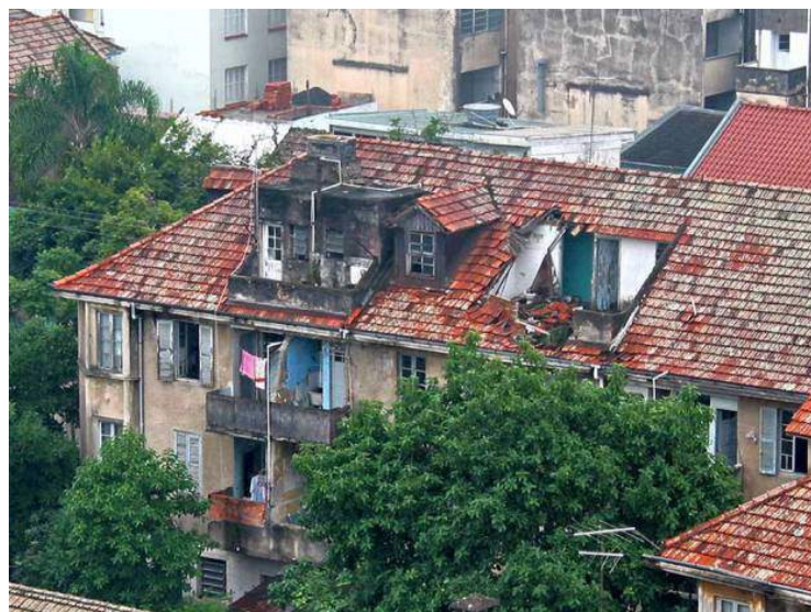
Figura 04: Degradação dos casarios.
