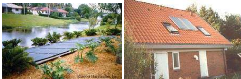
Figura 34: Exemplos de instalações de painéis solares para aquecimento de água [39]
