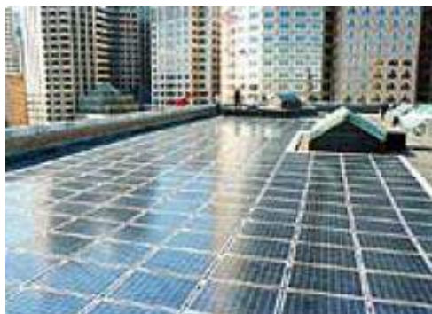
Figura 32: Exemplo de uma instalação de painéis fotovoltaicos
